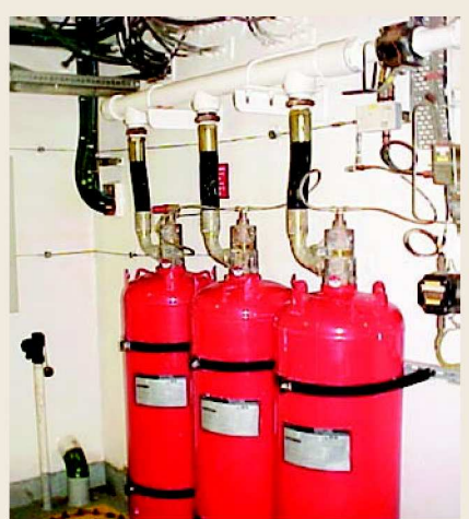
Рис. 2. На GSF Britannia и других буровых установках своего флота компания GlobalSantaFe начала выводить из эксплуатации существующие хладоновые системы пожаротушения и устанавливать новые альтернативные системы, не разрушающие озоновый слой
